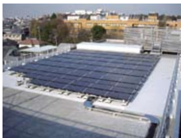
駒場研修センタに設置した太陽電池パネル
