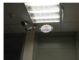
全部屋に監視カメラを設置
