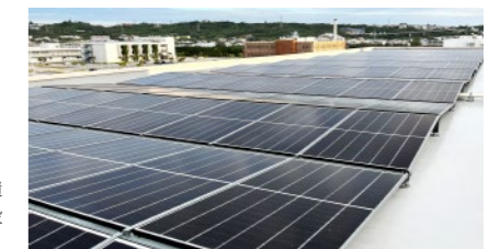
IT津梁パーク企業集積施設7号棟の屋上に設置した太陽光パネル
