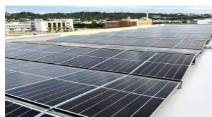
IT津梁パーク企業集積施設7号棟の屋上に設置した太陽光パネル
