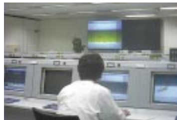
ネットワーク統合監視センター
